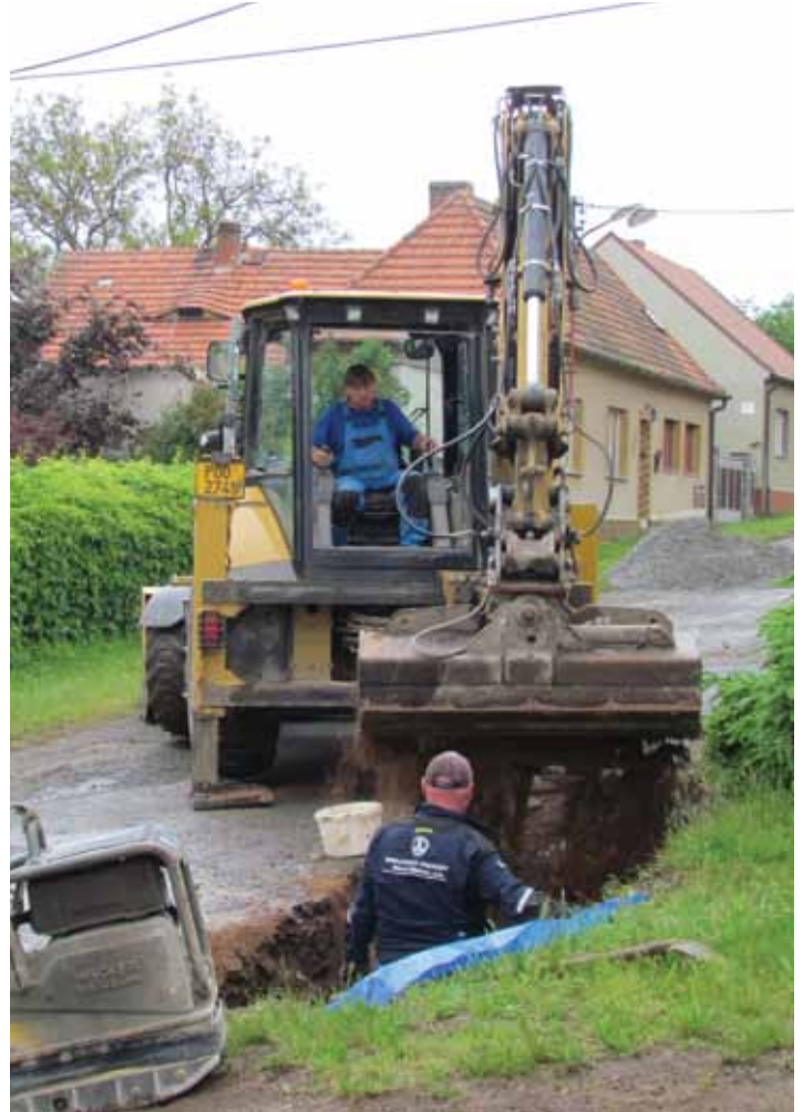
Během několika dnů opravili, a když bylo třeba vyměnili pracovníci KaV Starý Plzenec vodovodní šoupata ve dvou ulicích pod Hůrkou. A nyní se jen čeká na silniční asfaltové úpravy.
