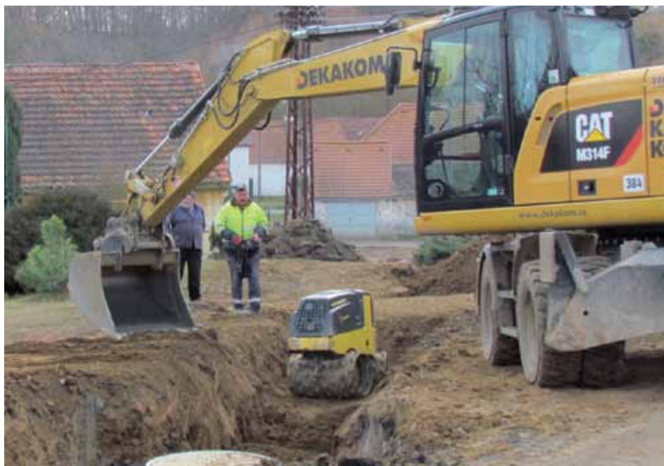
Práce na kanalizaci v Černotíně pokračují. Ani nepřesné plány a s tím spojené potíže při hloubení vedení trasy by neměly narušit daný harmonogram.
